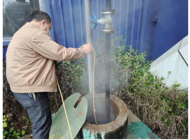
锅炉房冷却水排口（DW002）废水
